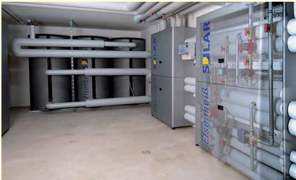
Wärme-Hybrid-Lösung im Mehrfamilienhausbereich.
